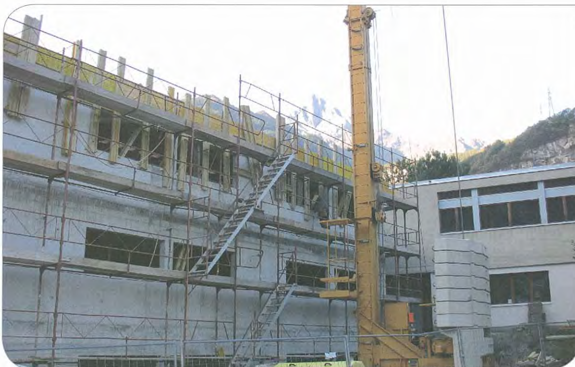
OCTOBRE 2009, CONSTRUCTION DE LA NOUVELLE AILE NORD POUR LES BUREAUX DES PROFESSEURS
