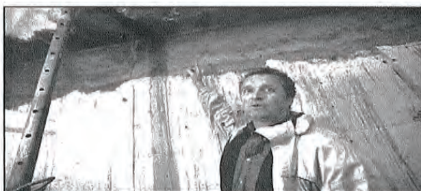
Les dégâts de l'incendie se sont répercutés d'un étage à l'autre, ainsi que le montre le directeur Patrice Clivaz. BITTEL
